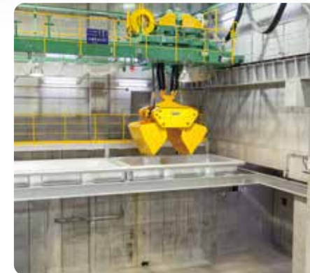
재 크레인·재 피트 쓰레기 소각 시 발생한 재는 소화된 후 재 피트로 옮겨집니다. 반출된 재는 일부 재활용 원료로서 효과적으로 이용됩니다.
