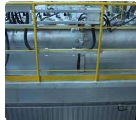
집진장치 집진장치는 내부에 전기 청소기의 필터와 비슷한 것을 504[개/기] 설치하여 미세한 재를 제거합니다.
