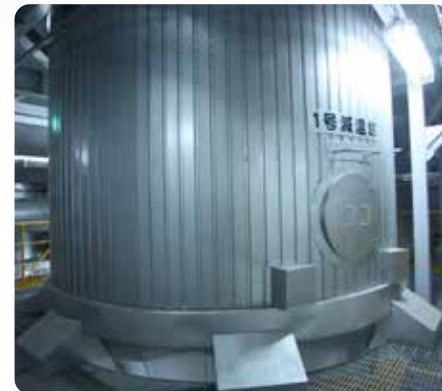
감온탑 배기가스는 재이용수를 분사하여 급냉시킵니다. 다이옥신류의 발생을 억제합니다.
