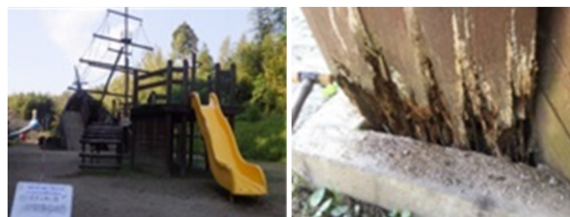
遊具の損傷状況
