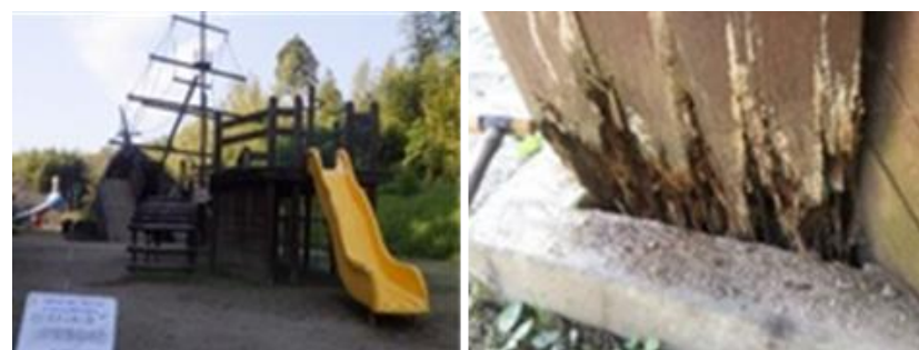
遊具の損傷状況
