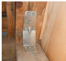
金物による補強
