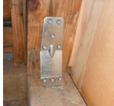
金物による補強
