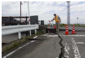
道路と橋梁の段差及び路面の亀裂
