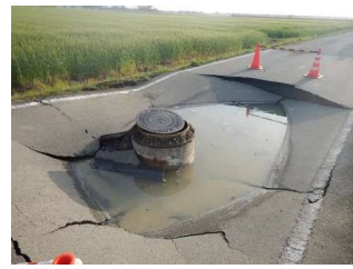
下水道(管路)の被災状況
