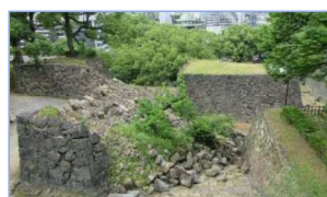
石垣の被災状況
