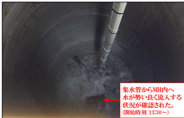
MHP7-3内への流入状況
