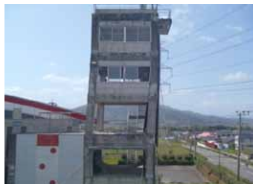
地震の衝撃で傾いた高さ 17m の主訓練塔
