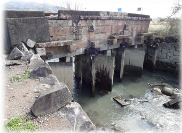
崩壊前の井樋堰
