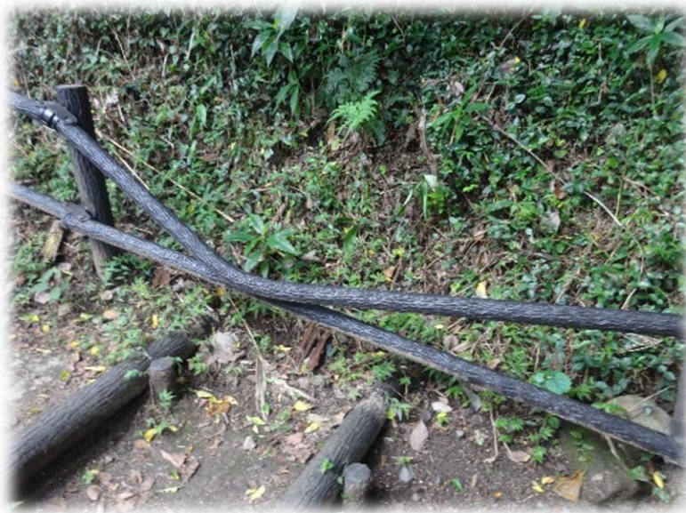
破損した手すり
