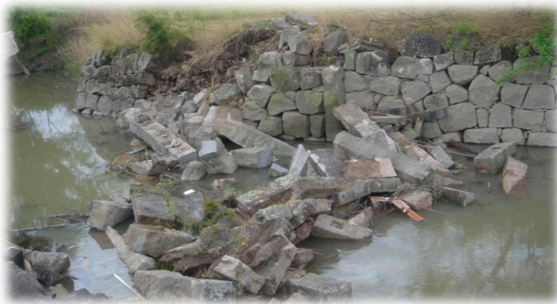
熊本地震により崩壊した井樋堰
