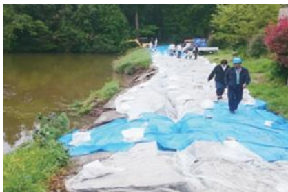
▲ため池の堤体の亀裂、陥没
