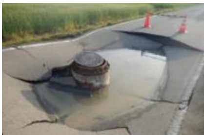
▲下水道（管路）の被災状況
