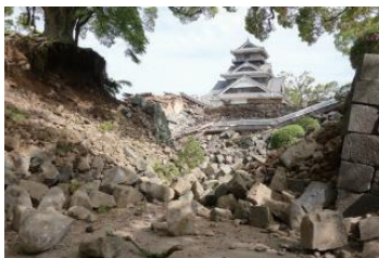
▲熊本城 石垣の崩壊 (平成28年)
