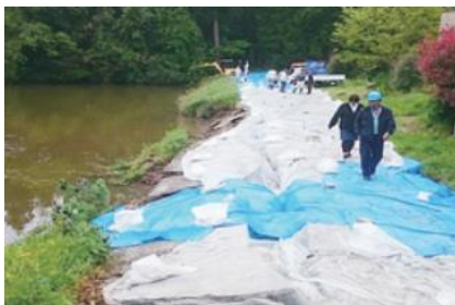
▲ため池の堤体の亀裂、陥没
