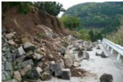
▲平山地区みかん園地の法面崩落
