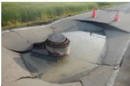
▲下水道（管路）の被災状況
