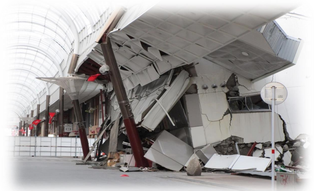
健軍商店街アーケードの被災状況
