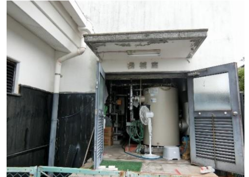
③ 外部機械室
