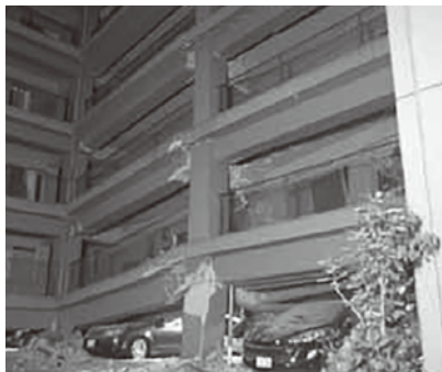
座屈した建物
