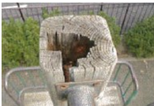
木製遊具の腐食
