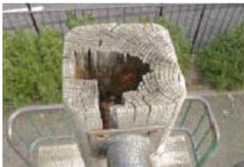
木製遊具の腐食
