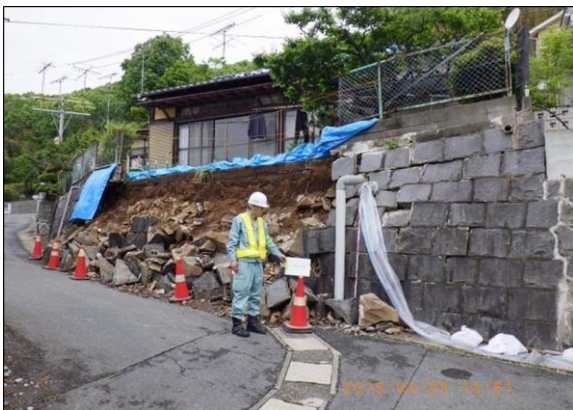
【擁壁崩壊被害】
