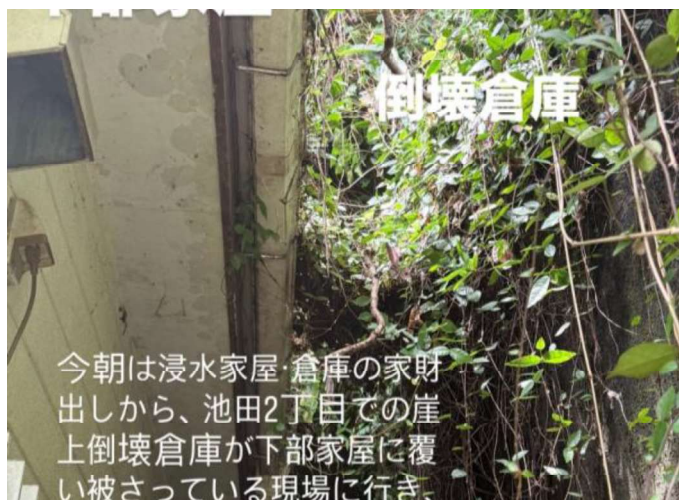
倒壊した倉庫が家屋を覆う
