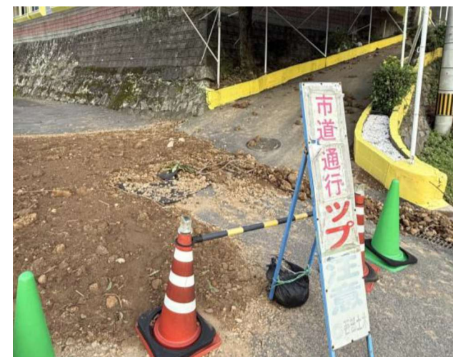
市道通行止め
