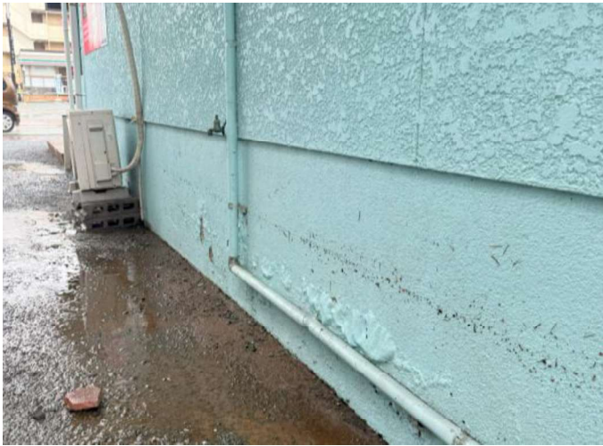
島崎2丁目建物外壁につく浸水跡
