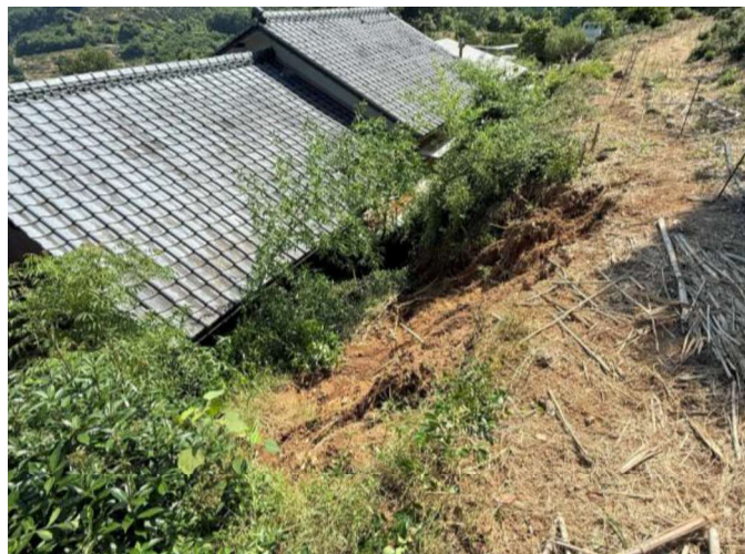
谷尾崎町大谷 民家への土砂流入
