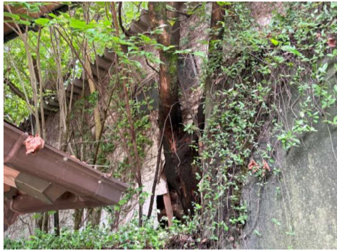
池田2丁目倉庫崩落による被害
