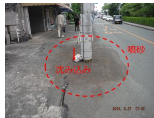
噴砂・電柱の沈み込み
