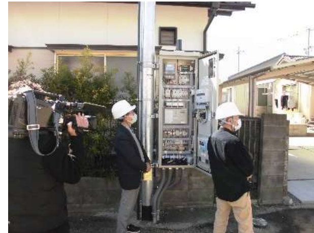
写真1. ポンプの起動
