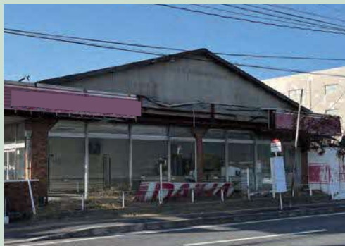
老朽化により落下した広告物
