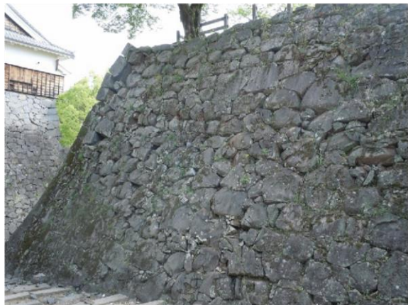
⑳ 東三階櫓台石垣の膨らみ・緩み
