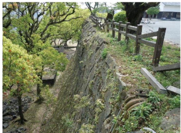
㉗ 本丸北輪居櫓台石垣の膨らみ
