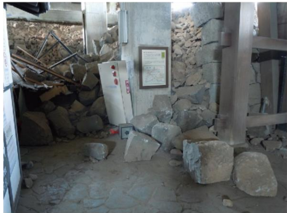
⑫ 小天守穴蔵石垣の崩落
