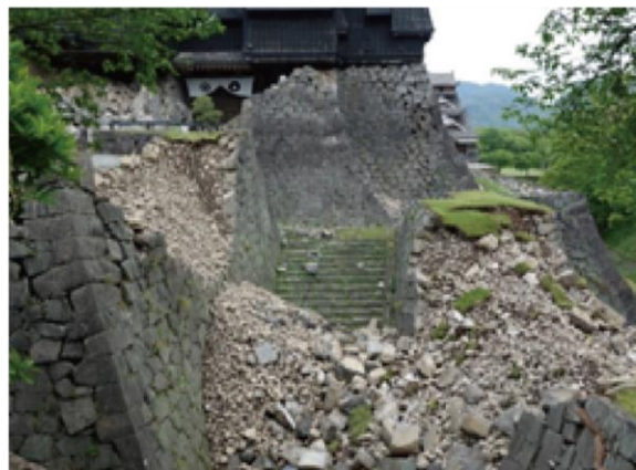
㉔ トキ櫓台と石門上部石壁の崩壊
