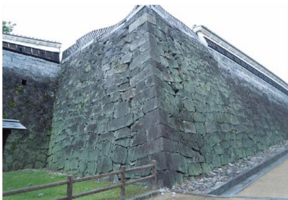
⑧奉行丸南東石垣の膨らみ
