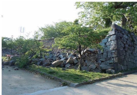
⑤⑤ 二の丸西口西側石垣の崩落
