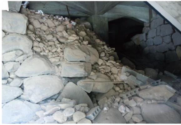
⑫ 大天守穴蔵石垣の崩落
