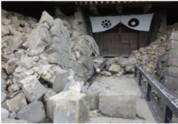
⑫ 小天守入口石垣の崩落
