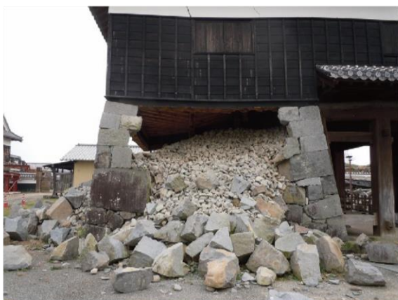
④西大手櫓台石垣の崩落
