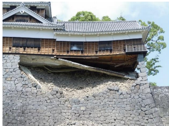
③⑥ 飯田丸五階櫓台石垣の崩落
