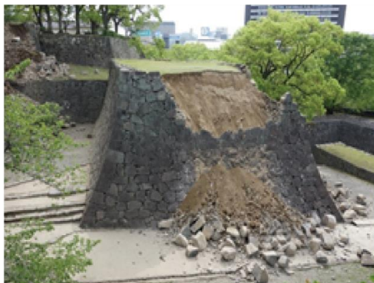
③⑧ 竹の丸五階櫓石垣の崩壊
