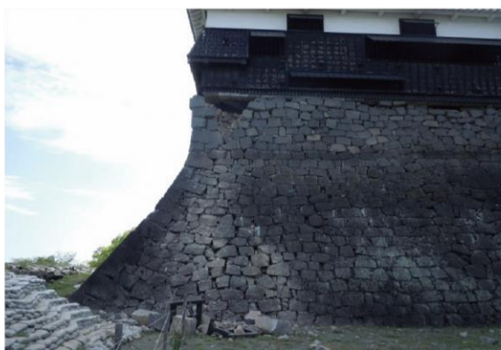
⑫小天守石垣北西隅の崩落・緩み
