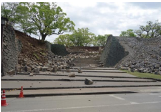
⑤① 二の丸御門跡石垣の崩壊
