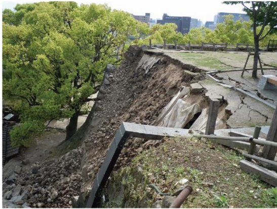
②⑦ 長局北側石垣の崩落
