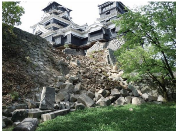
㉑ 北埋門ノ上居櫓台の崩落（北から）
