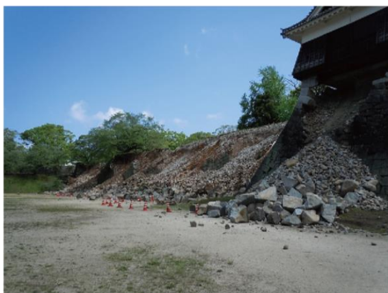
①西出丸北側石垣の崩落
