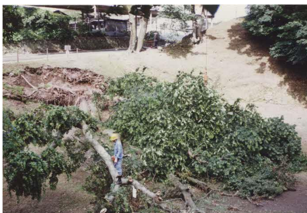
事例3：倒木による法面崩落
