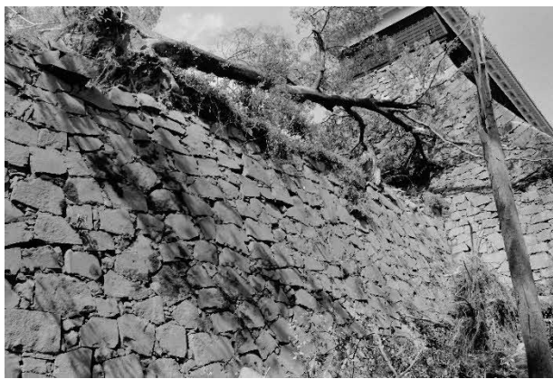
事例4：倒木による東十八間櫓石垣天端石の変状
