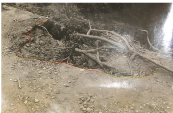
事例1：加藤神社石垣天端石の崩落
