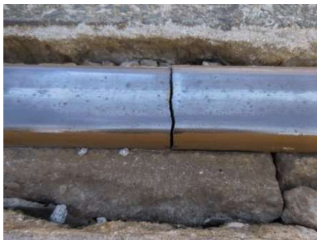
市電レールの破断
