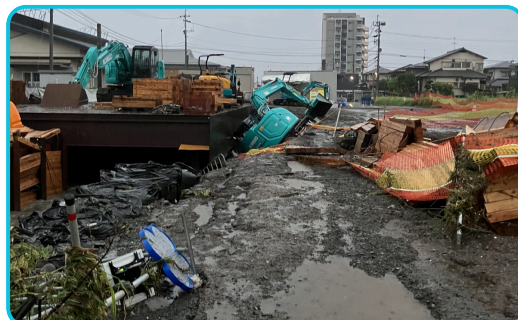
資材が流された後の健軍川工事現場の様子
