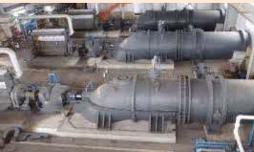
元三排水機場：農地だけでなく、住宅地の浸水も防止しています
