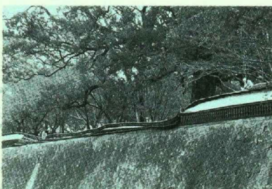
台風19号の被害
