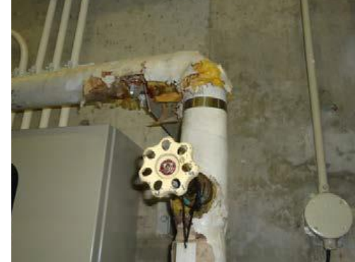
配管 (腐食、保温材破損)
