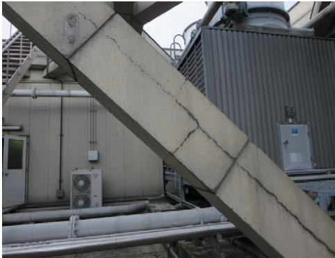
ブレース (著しい汚れ、ボードのひび割れ)
