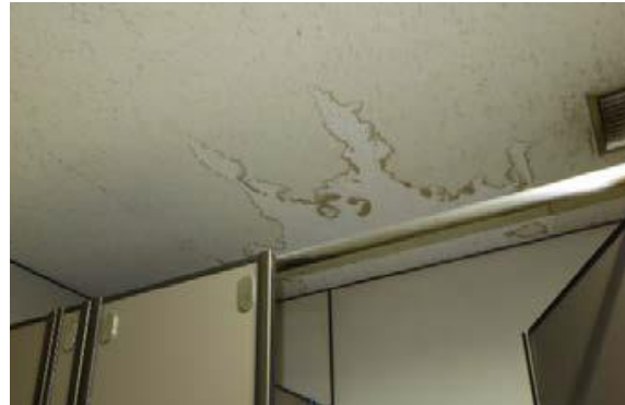
天井 (配管からの漏水等による水染み)
