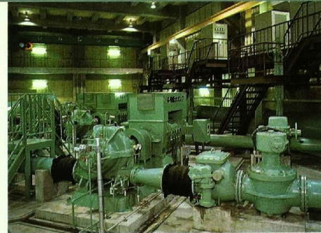
秋田配水場配水ポンプ
