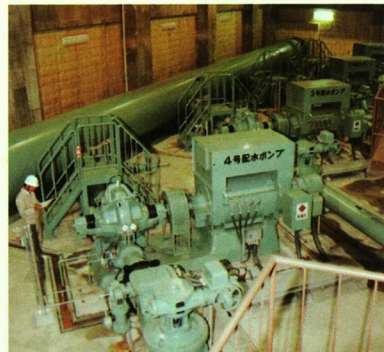
秋田配水場配水ポンプ
