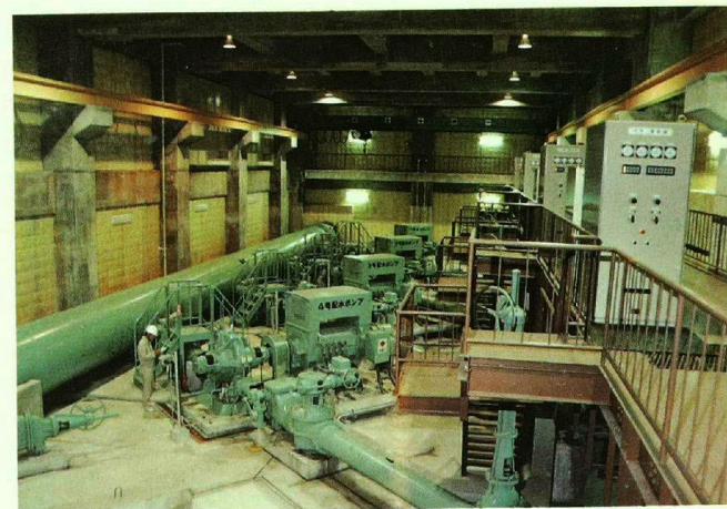
秋田配水場配水ポンプ
