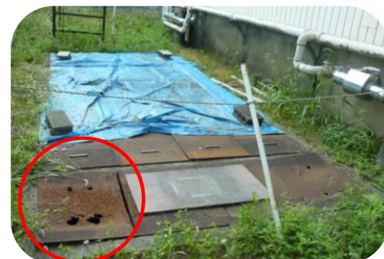
不具合事例③：鉄蓋の腐食 ⇒通行人落下の恐れ
