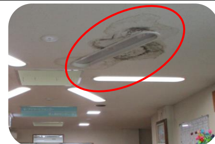
不具合事例①：天井から雨漏り ⇒天井落下や漏電等の恐れ
