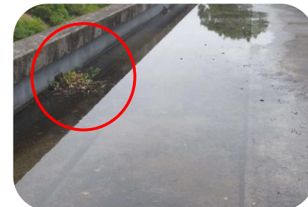
不具合事例②：排水口の枯葉詰まり ⇒屋上に雨水が溜まったままとなり 雨漏りの恐れ
