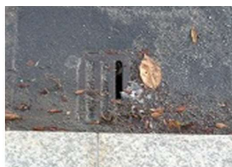
排水枡の土砂詰まり
