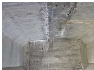
雨水浸入による床版下面の遊離石灰
