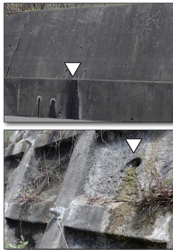
地下水の流出
