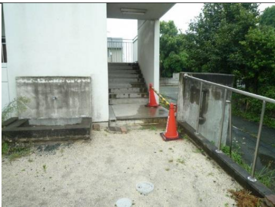
屋外段差 (改修前)
