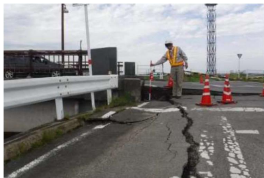
道路と橋梁の段差及び路面の亀裂
