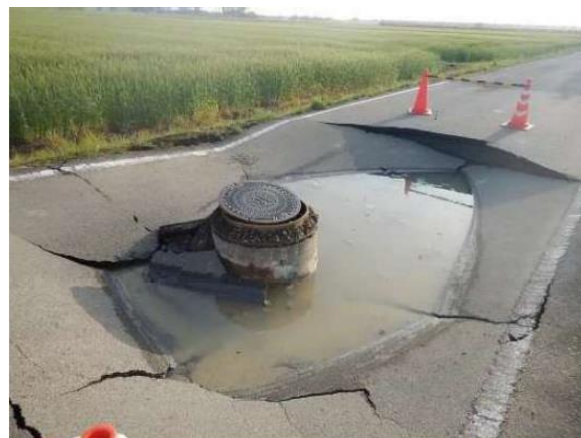
下水道(管路)の被災状況
