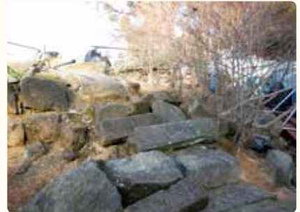
櫓東側の崩れた石垣
