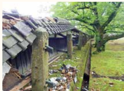
屋根瓦が落ちた長塀のようす
