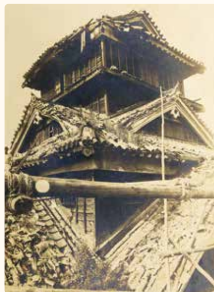
1927年に修理される前の傷んだ宇土櫓
