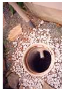
雨水浸透ます
