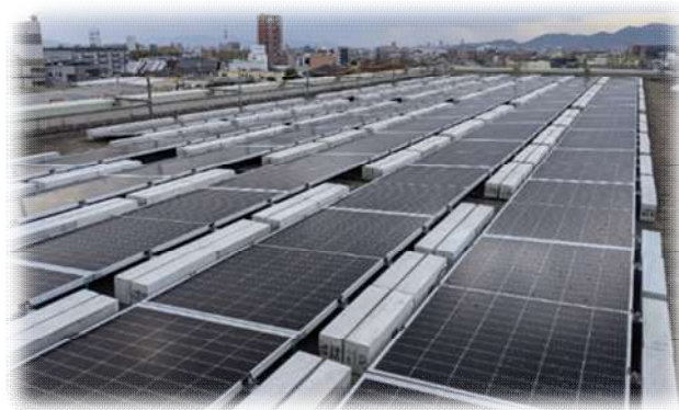
PPA 方式を活用した太陽光発電設備（託麻西小学校）
