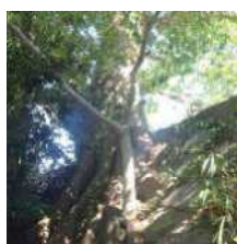
〈石垣の面上に生育し、 石垣を変形させる樹木〉
