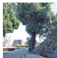
〈石垣底部に生育し、 石垣を押し上げるなど 石垣を変形させる樹木〉
