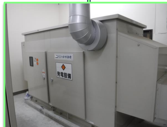
非常用発電機
