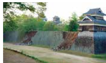
▲前震後の戌亥櫓東石垣の被害
