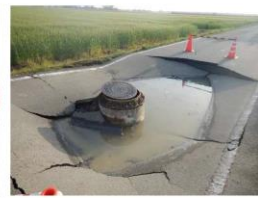
下水道(管路)の被災状況
