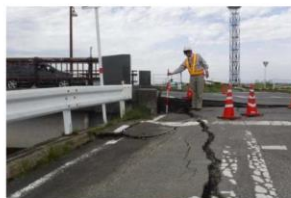
道路と橋梁の段差及び路面の亀裂
