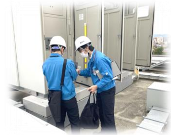
施設の安全確認
