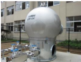
貯水機能付給水管
