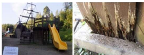
遊具の損傷状況
