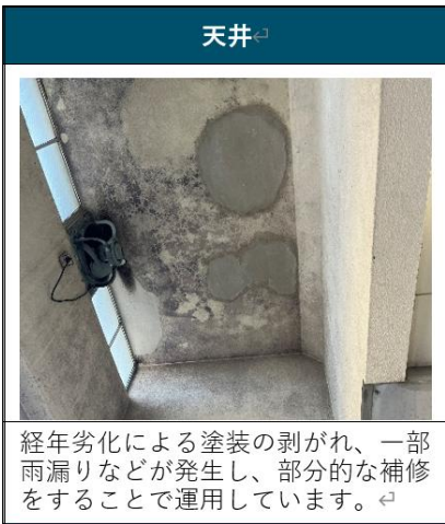
給食施設の劣化状況例
